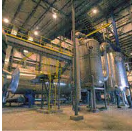
Figure 35 : Usine de démonstration de Pyrovac, Saguenay
